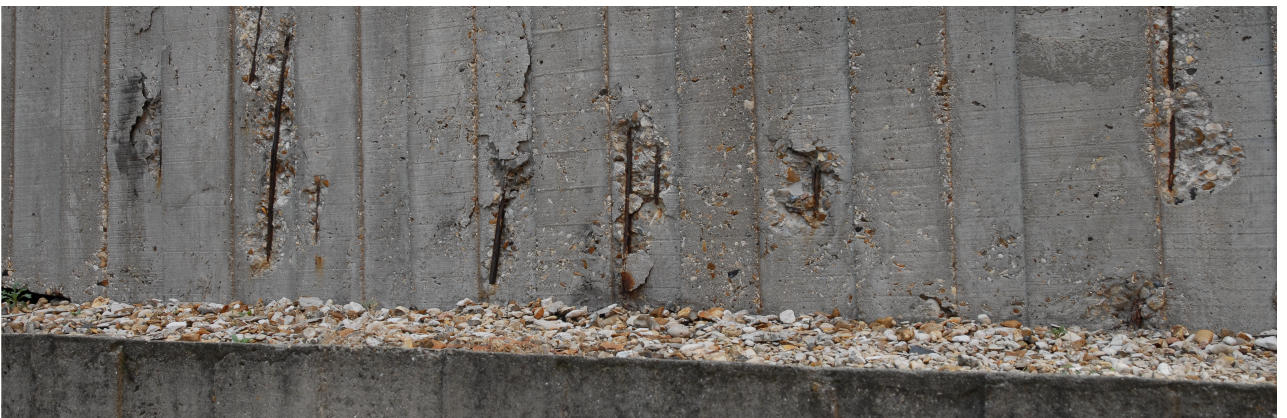
Éclatement du parement en raison de la corrosion des armatures sur un bâtiment public
